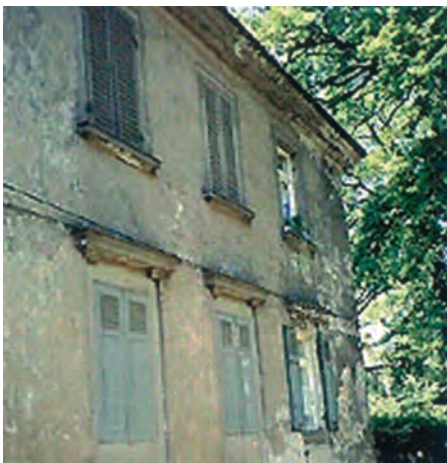
Wasserschäden an einem Altbau
